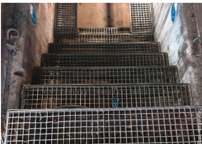
Abgenutzter Treppen-Gitterrost/fehlender Boden-Gitterrost
