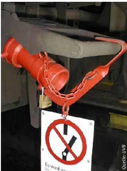
Der aufgesteckte Blindstecker verhindert hier ein irrtümliches Anschließen einer Fremdeinspeisung
