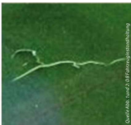
Abbildung 2: Sichtbar gemachte Oberflächenrisse
