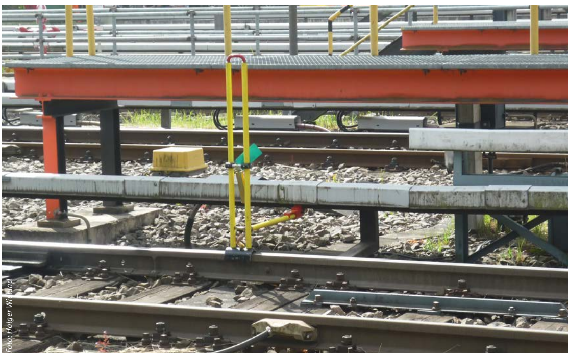
Abbildung 5: Sicherungseinrichtung an der Stromschiene
