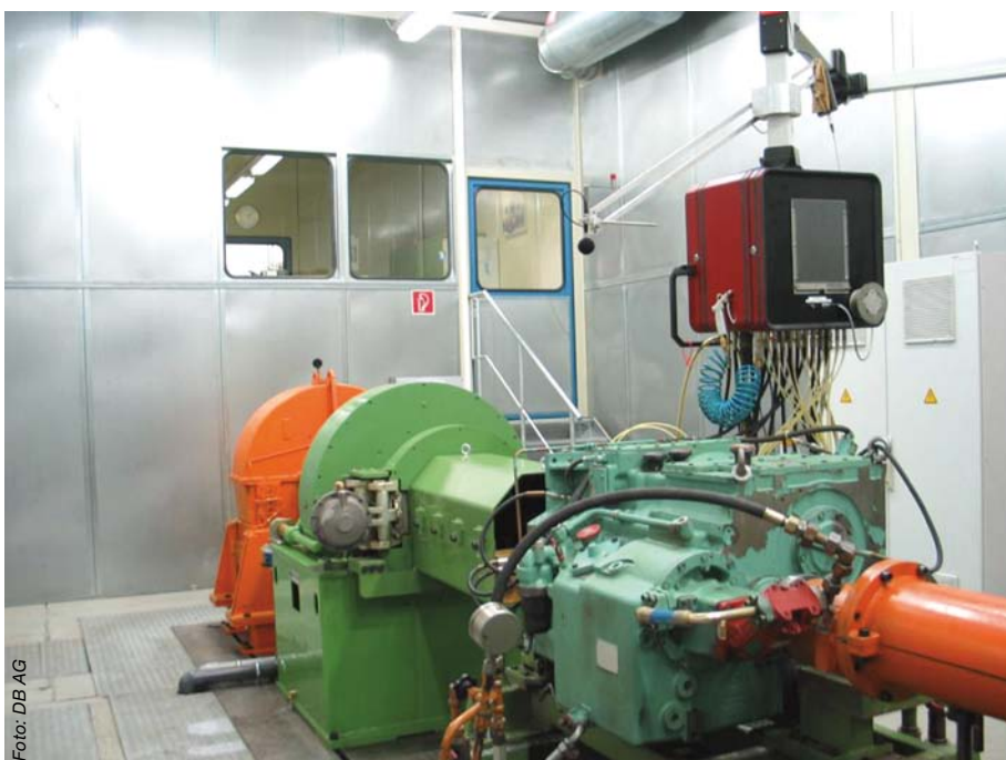
Abbildung 3: Einhausung eines Aggregats
