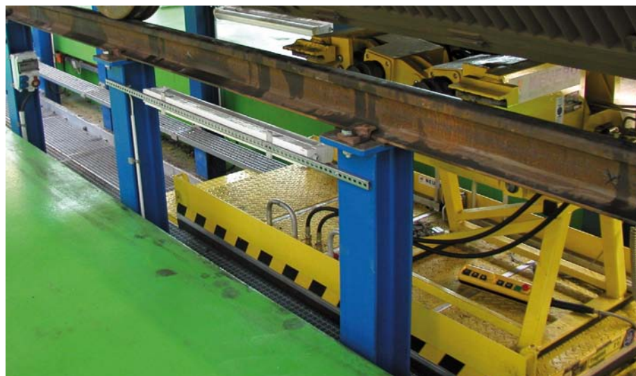
Eine Sonderanfertigung für die Bahn ist die Rundlauf-Prüfmaschine, eingebaut in die Arbeitsgrube unter dem aufgeständerten Gleis
