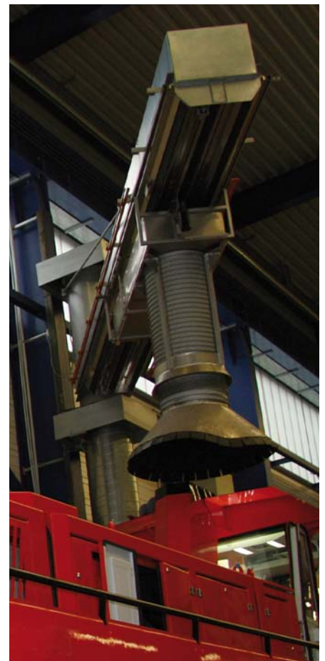
Absaugung von Dieselabgasen.
