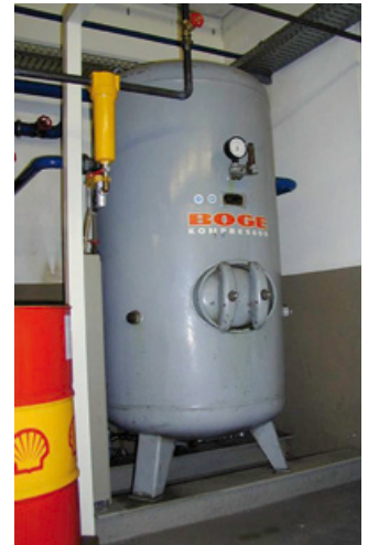
Abbildung 4: Dieser Druckluftbehälter ist als überwachungsbedürftige Anlage durch eine zugelassene Überwachungsstelle wiederkehrend zu prüfen. Foto: Privat.
