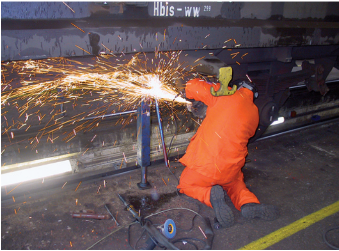
Abbildung 1: Funkenflug beim Beschleifen der Schadstelle.
