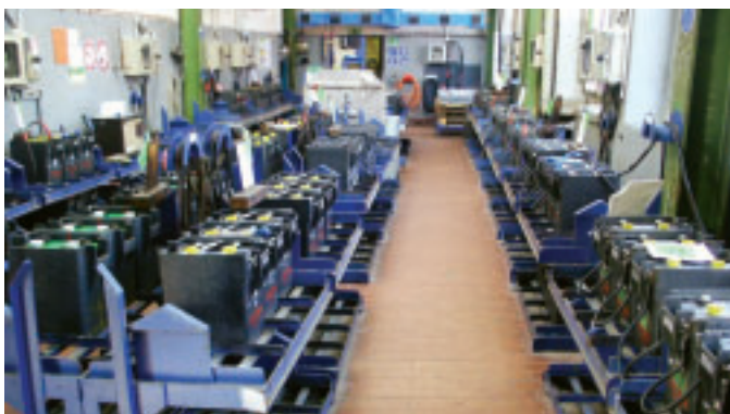
Abbildung 3: Batterieladerraum. Auslaufender Elektrolyt kann hier Rutschstellen schaffen.
