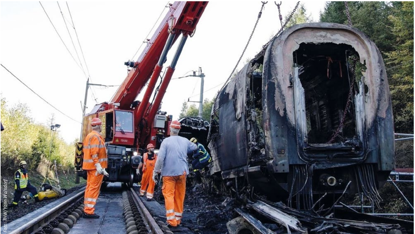
Abbildung 2: Mitarbeitende der Notfalltechnik bergen die Überreste eines ausgebrannten ICE. Hinsichtlich der Gefahren aus erkalteten Brandstellen beraten die Fachkräfte für Arbeitsschutz, Brandschutz oder Umweltschutz.
