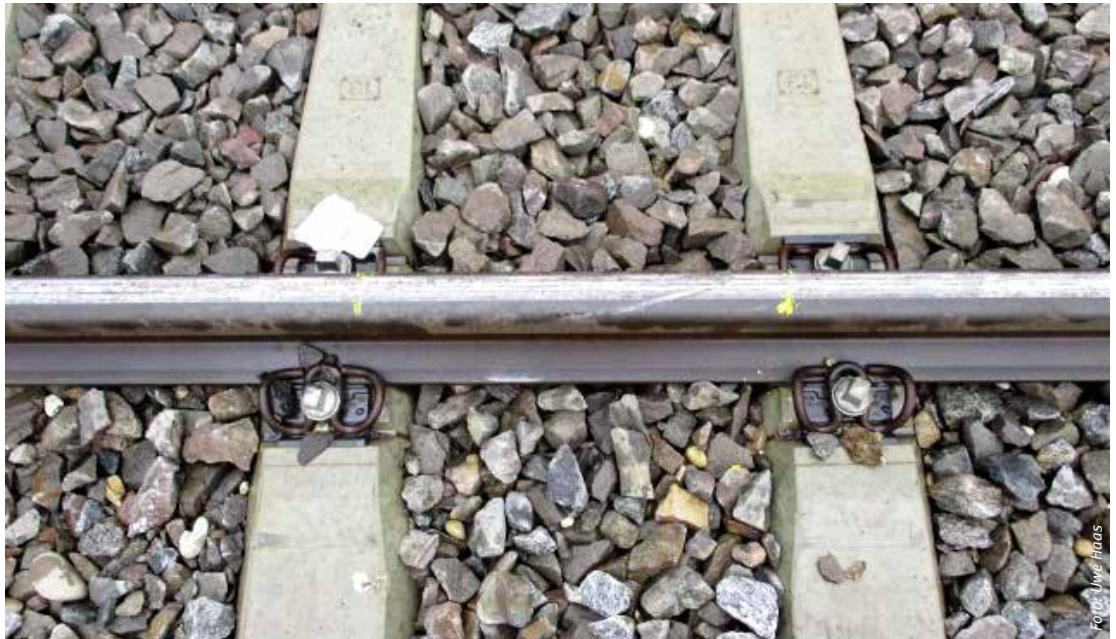
Abbildung 9: Entgleisungsspuren geben oft Auskunft über Hergang und Ur- sache eines Ereignisses
