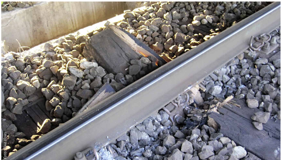
Abbildung 12: Bildliche Dokumentation einer gebrochenen Holzschwelle
