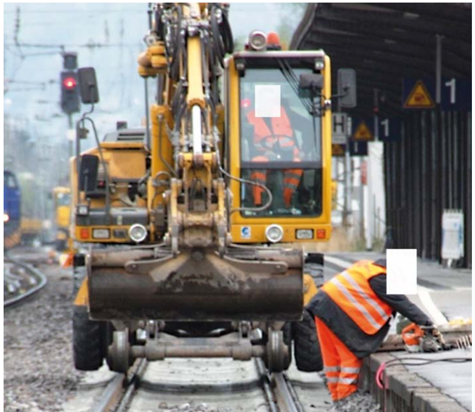
Abbildung 4: Beschäftigter vor Zweiwegebagger, Triebfahrzeugführer hält davor an
