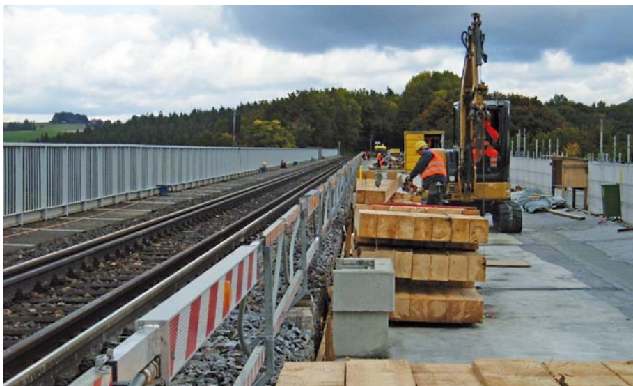
Abbildung 2: Feste Absperrung mit integriertem automatischem Warnsystem bei beengten Platzverhältnissen. Die Beschäftigten müssen den Arbeitsbereich unmittelbar neben der festen Absperrung nach der Warnung verlassen.
