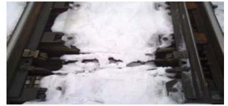
Abbildung 2: Mit Schnee zugewehtes Verschlussfach am Spitzenverschluss mit beginnender Vereisung im durchgehenden Hauptgleis mit 2 x 250 W Heizung (Foto: PD MÜ, Richter)
