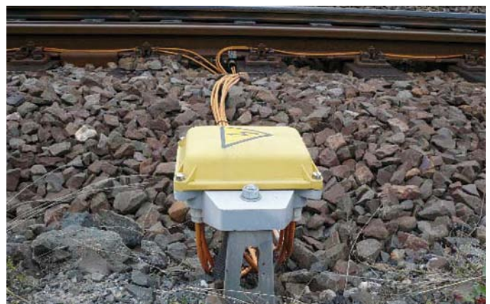
Abbildung 3: Anschlusskasten einer elektrischen Weichenheizung im Gleisbereich
