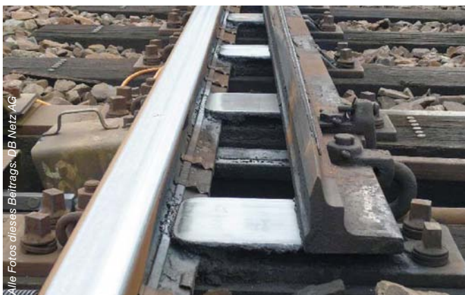
Abbildung 2: Heizstab einer elektrischen Weichenheizung an der Backenschiene
