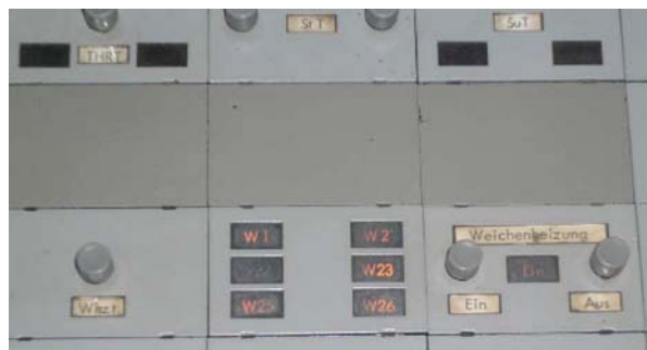
Abbildung 5: In den Stelltisch integrierte Bedieneinheit einer Weichenheizung
