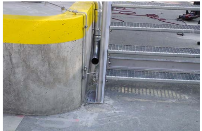
Abbildung 6: Regenwasser-Ausfluss an einer Treppe
