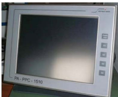
Abbildung 4: Moderne Bedien- und Anzeigeeinheit einer Weichenheizungsanlage beim Fdl
