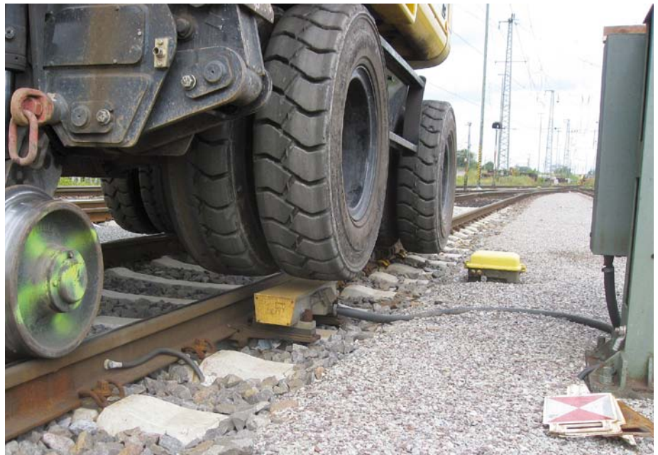
Abbildung 4: Überfahren einer PZB-Streckeneinrichtung
