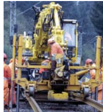
Unser Titelbild: Zweiwegebagger im Einsatz bei der Oberbauerneuerung. Foto: DB AG/Claus Weber.
