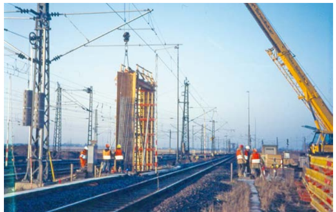
Abbildung 5: Kranarbeiten bei freigeschalteter Fahrleitung: vor und hinter der Arbeitsstelle ist eine Bahnerdungsvorrichtung eingebaut.
