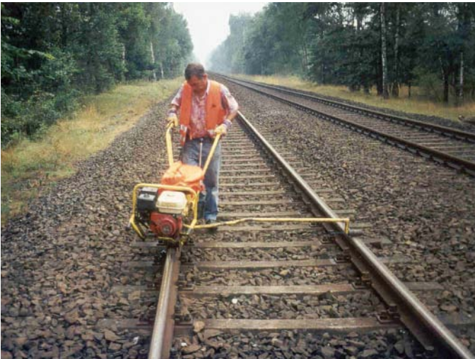
Abbildung 7: Bei Arbeiten mit Maschinen, z.B. Schraubmaschinen, muss das Arbeitsgleis gesperrt sein. Eine zeitgerechte Räumung würde hier mindestens zwei Beschäftigte ständig an der Maschine erfordern.
