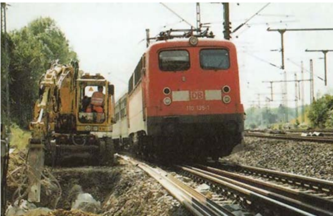
Abbildung 8: Es kann die Gefahr des unbeabsichtigten Schwenkens des Auslegers in das Betriebsgleis bestehen.
