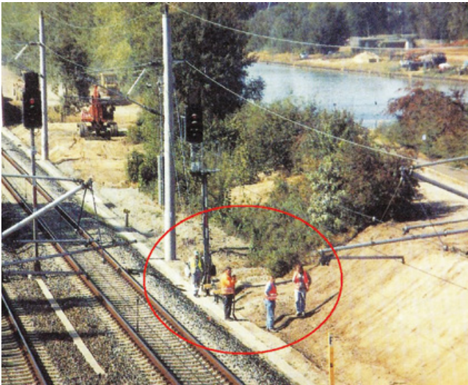
Abbildung 1: Die Beschäftigten arbeiten auf dem Randweg außerhalb des Gleisbereichs. Ob die Gefahr besteht unbeabsichtigt in den Gleisbereich zu gelangen, entscheidet der bauausführende Unternehmer.
