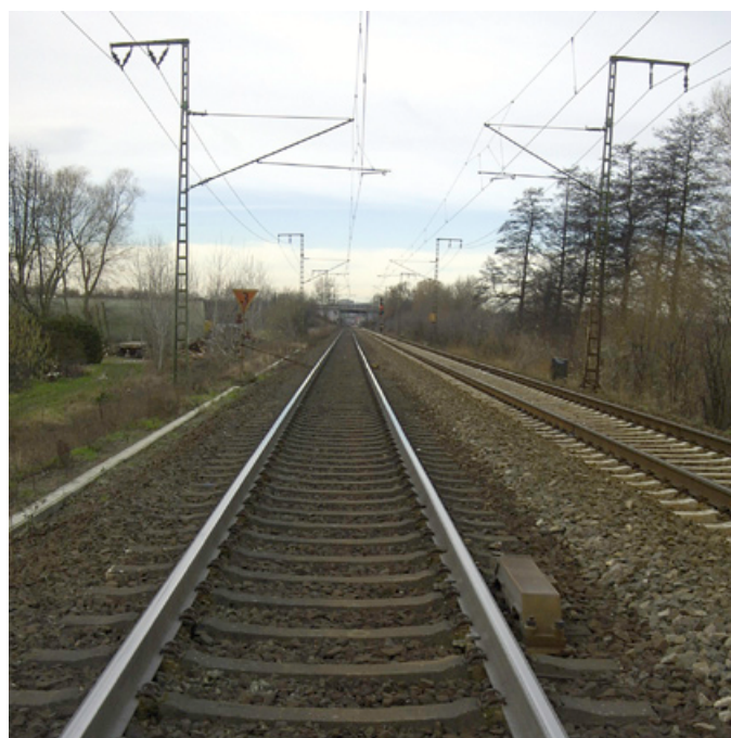
Abbildung 2: PZB-Magnet am Gleis – 500 Hz-Magnet.
