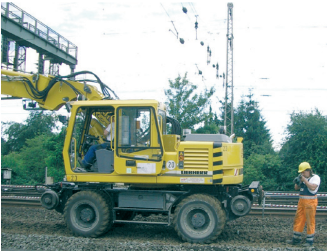
Abbildung 1: Aufenthalt im Fahrbereich eines Zweiwegebaggers.
