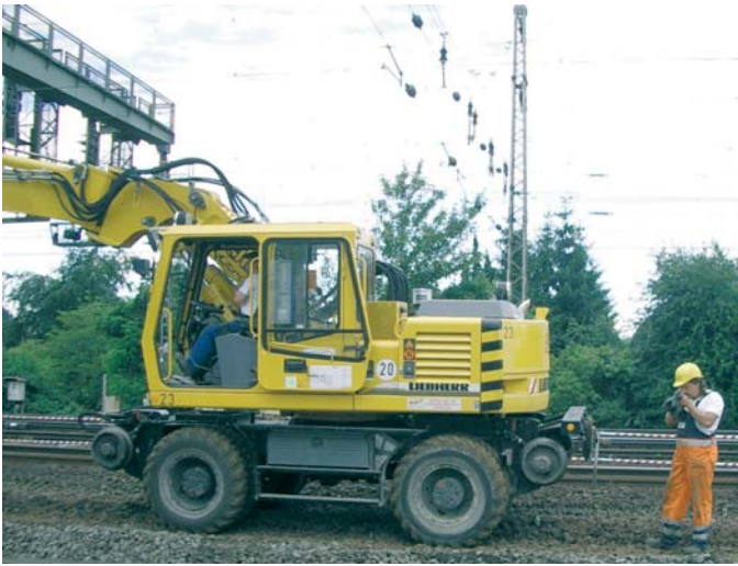
Abbildung 1: Aufenthalt im Fahrbereich eines Zweiwegeladders.
