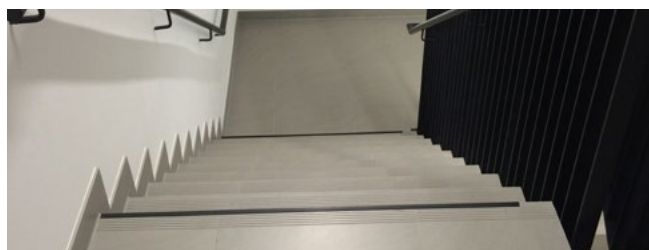
Abb. 14 Geflieste Treppe in Arbeitsstätten, unzureichend gekennzeichnet
