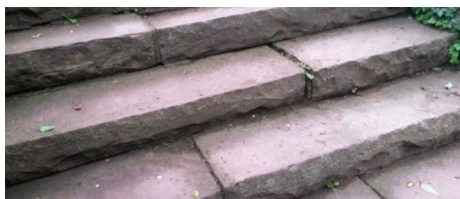
Abb. 16 Außentreppe mit erhöhtem Abrieb
