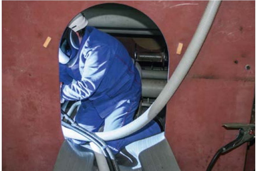
Abb. 5-1 Beispiel für erhöhte elektrische Gefährdung beim Schweißen
