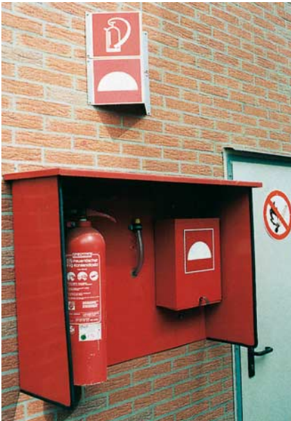
Feuerlöscher und Löschdecke im Stützpunkt
