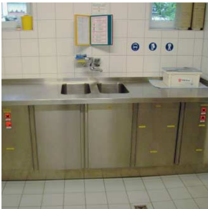
Reinigungs- und Desinfektionsraum
