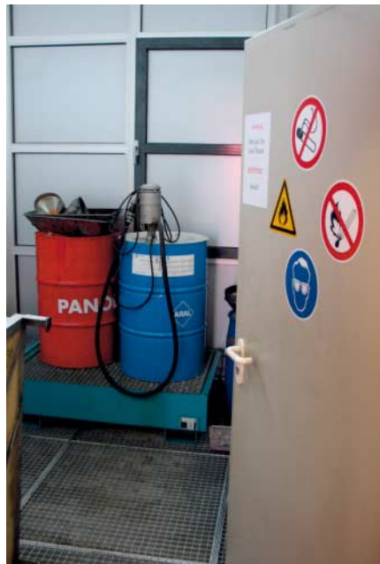
Lageraum für brennbare Flüssigkeiten mit Sicherheitszeichen an der Tür
