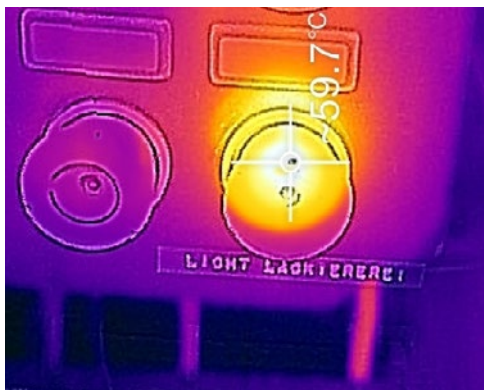
Abb. 24.2 Verteilung mit Diazed-Sicherungen; Thermographiebild
