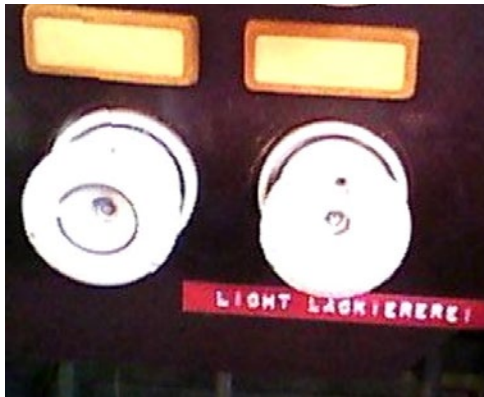
Abb. 24.1 Verteilung mit Diazed-Sicherungen
