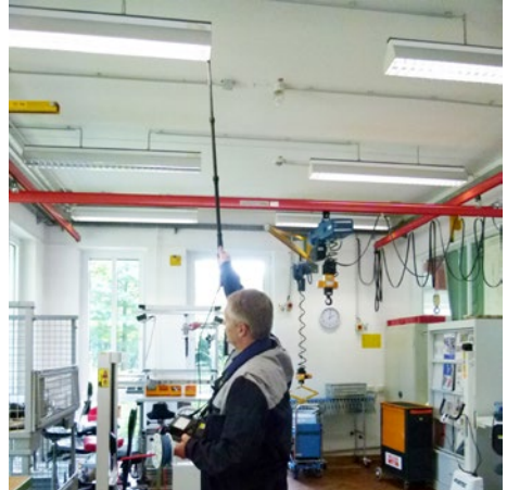
Abb. 9 Messung der niederohmigen Schutzleiterverbindung; Leuchte
