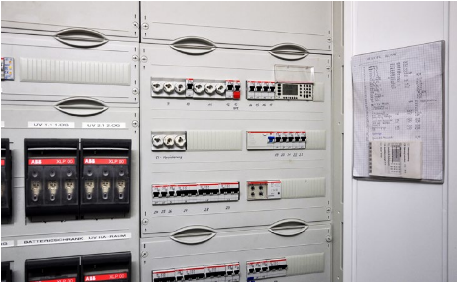
Abb. 4 Stromkreiskennzeichnung und zugehörige Dokumentationen einer elektrischen Unterverteilung
