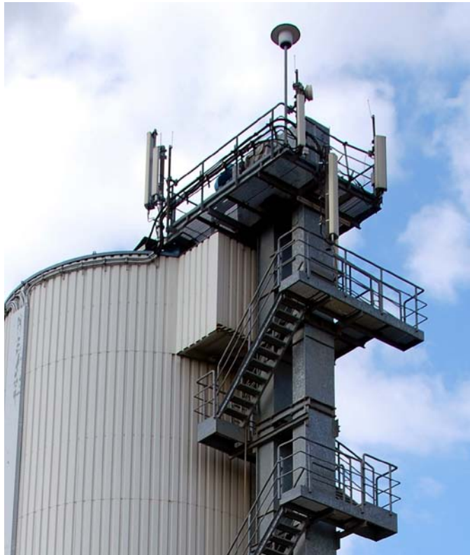
Bild 20 Mobilfunkanlage auf einem Silo
