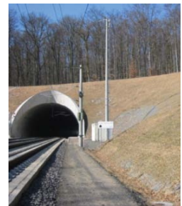
Bild 24 Mobilfunkanlage in der Nähe von Gleisanlagen
