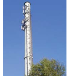
Bild 22 Funkanlagen auf Schornstein
