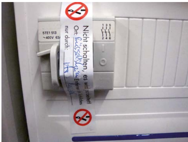
Bild 5-11: Gegen Wiedereinschalten gesicherter Hauptschalter
