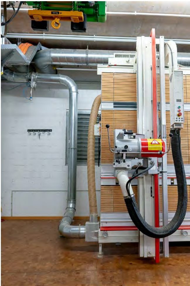
Abb. 3.1.2-07 Absauganlage an einer vertikalen Plattensäge
