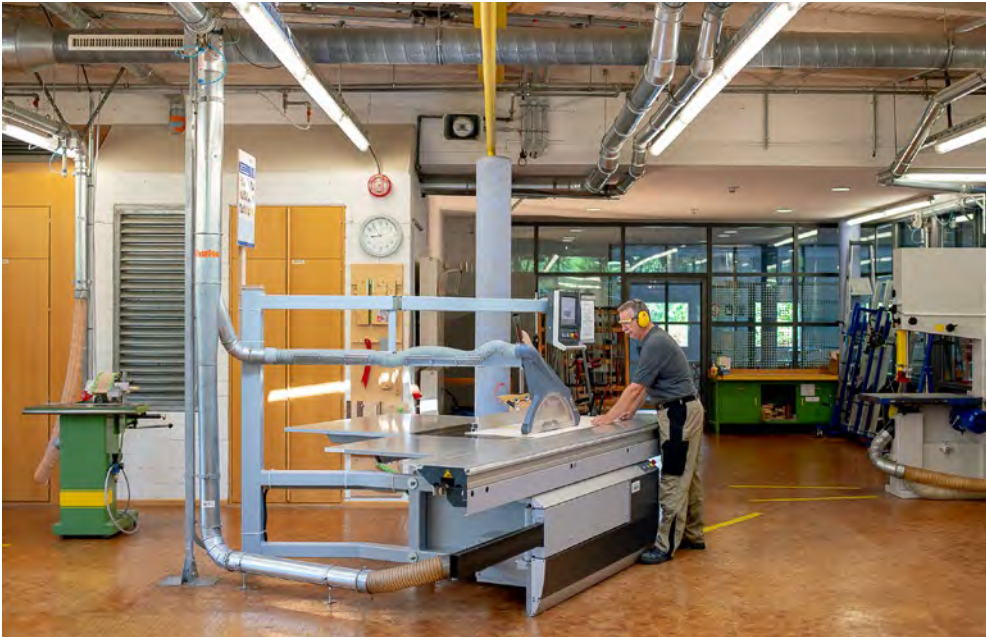
Abb. 2.2.3-01 Absauganlage an einer Holzbearbeitungsmaschine
